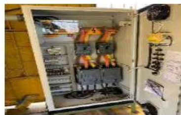
Foto 2. Tablero de control eléctrico para equipos de bombeo
