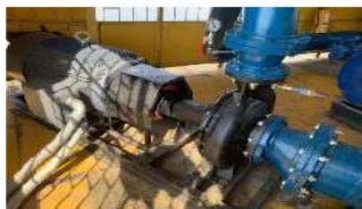
Foto 1. Equipo de bombeo en Componente de Captación – 120 L/Seg
